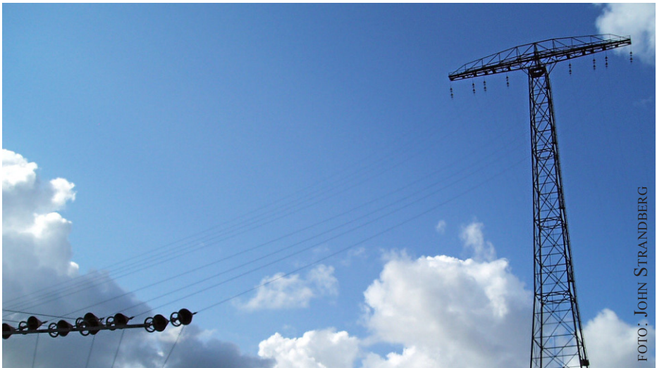
Antennströmmen fördelas över antennen via åtta topplinor.
