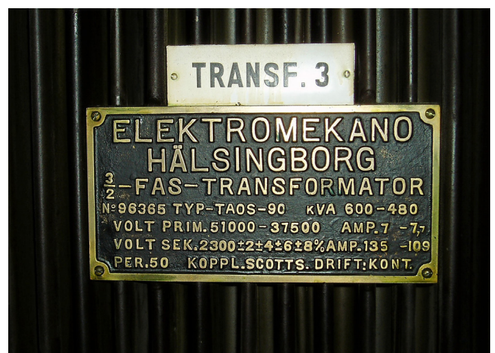
Märkplåt för 3-fas/2-fas transformator
